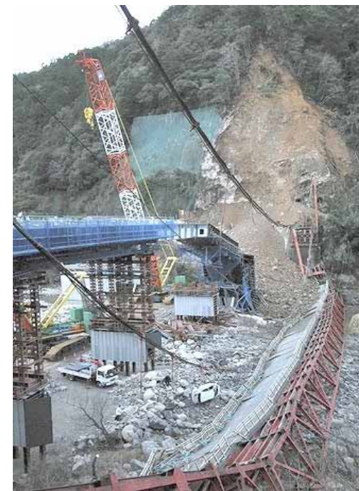
2015.1.31 浜松市原田橋 崩落 2名死亡
