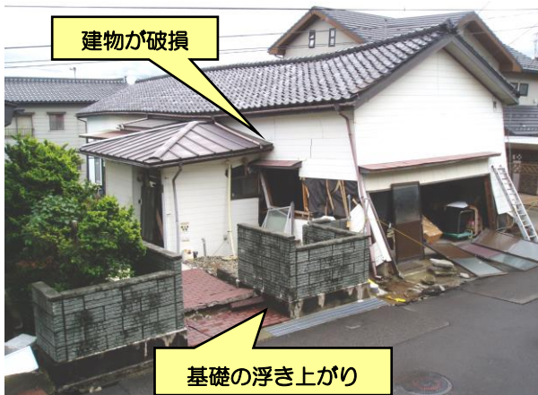
写真-3 液状化による宅地被害
