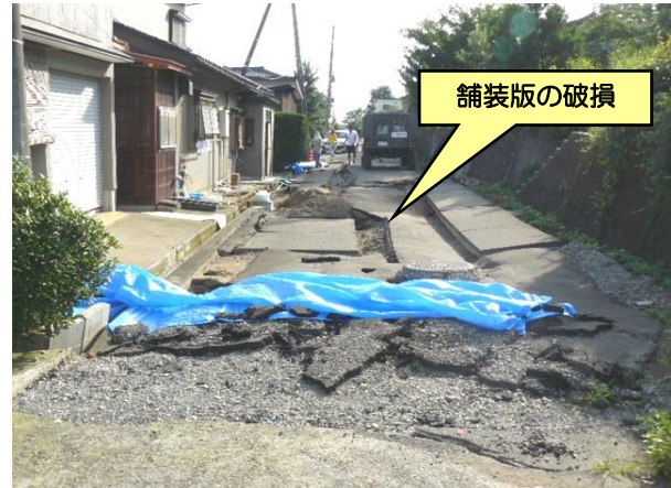
写真-4 液状化による舗装版の破損
