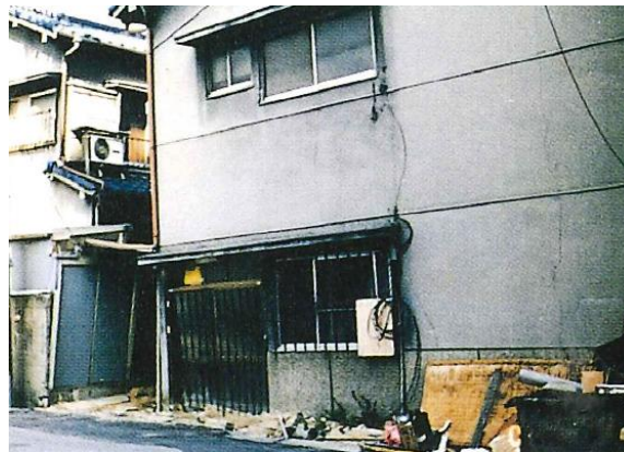
写真-2 建物の沈下状況
