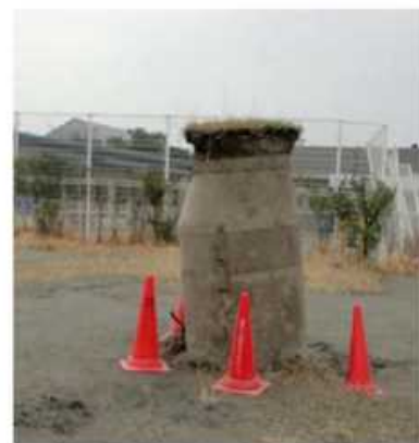
写真 1-2 地下埋設物の浮き上がり
