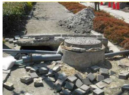
写真 1-5 マンホールの浮き上がり現象
