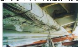
塩害によるコンクリート構造物の劣化事例
