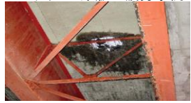
コンクリート床版の疲労事例
