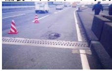
舗装のポットホール事例
