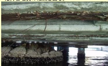
<劣化や変状が顕在化した施設の増加>
