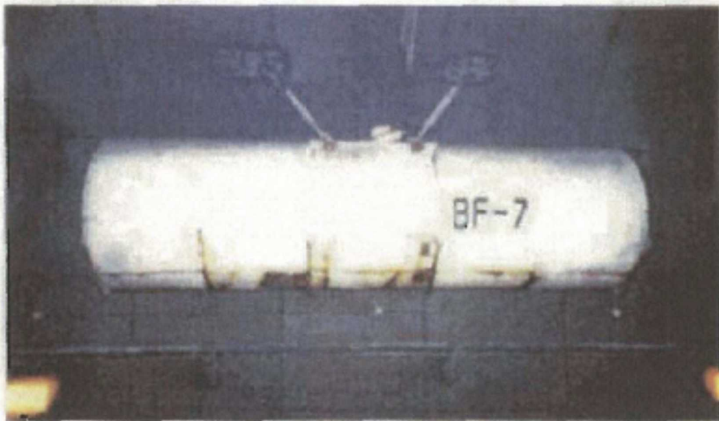
写真－２ 発錆、腐食状態のランク [C]
