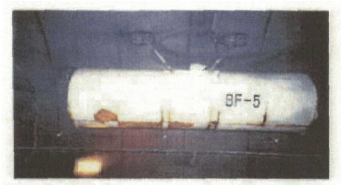
写真－3 発錆、腐食状態のランク [D]
