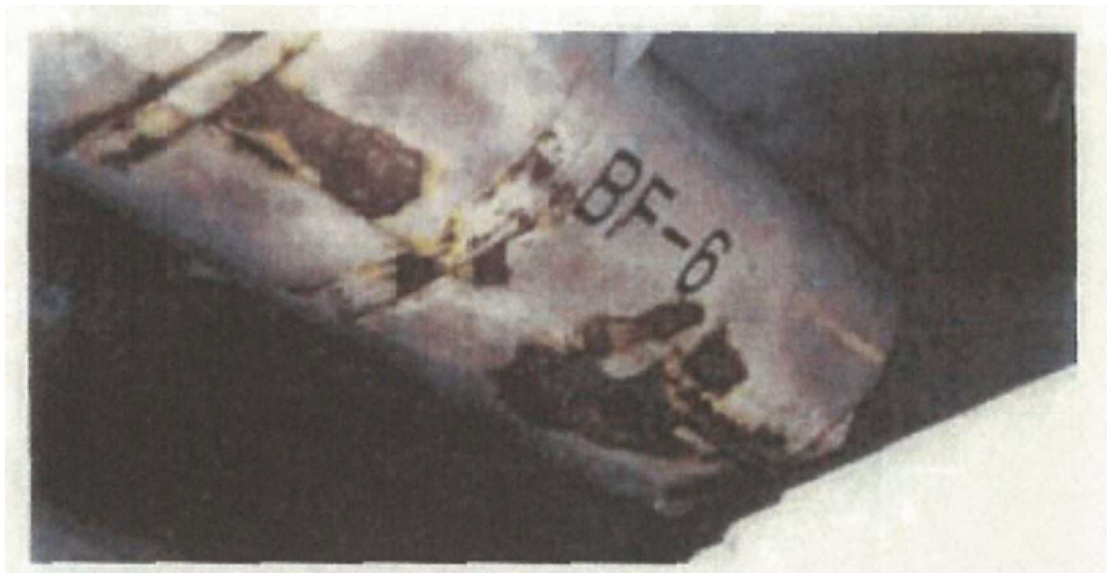
写真－4 発錆、腐食状態のランク [E]
