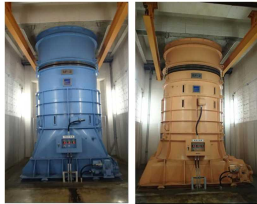
送・排風機設備の事例
