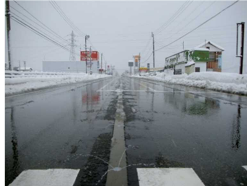
消融雪設備の事例
