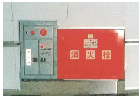
トンネル非常用施設の事例
