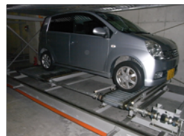
機械式駐車場設備
