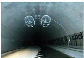
トンネル換気設備
