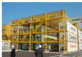
省電力冷蔵コンテナ設備
