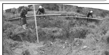
TEC-FORCEによる被災状況調査（大空町）
