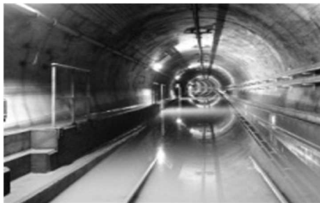
H25.9 京都市交通局(御陵駅及びトンネル) 台風による安祥寺川の氾濫 (4日間運休、約45万人に影響)
