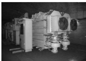
【変電所設備の一例】
