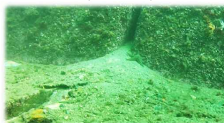
写真8. 港湾構造物の前肢端部の状態 (深度約7m)
