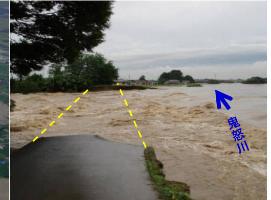
被災状況(拡大写真)
