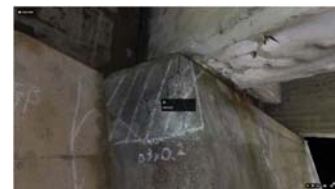
※1 3Dモデル損傷部タグ付け
