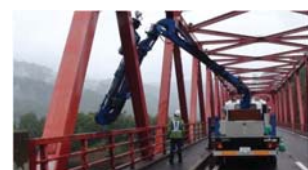
点検システムの背面
