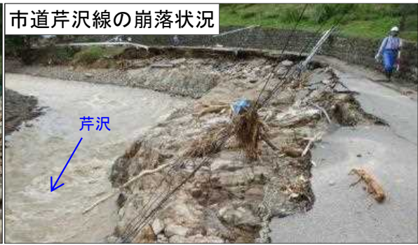
負傷者2名、家屋全壊5戸、半壊2戸 市道芹沢線が分断 住民25名が一次孤立
