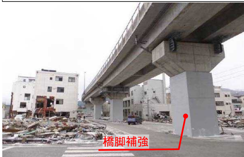
国道45号(観測震度: 震度6弱 )
