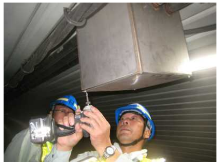
ねじの緩みの締め付け
