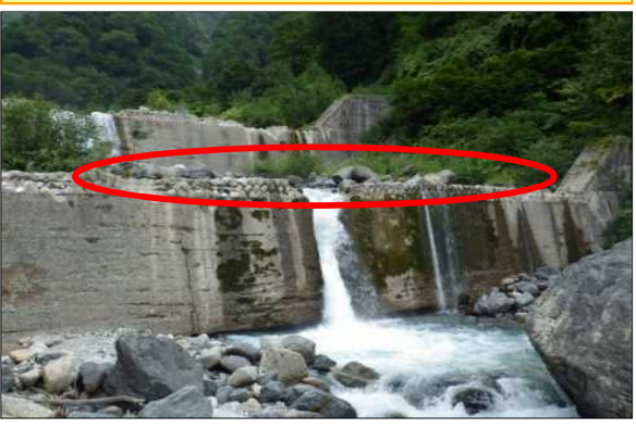
水通し天端の摩耗
