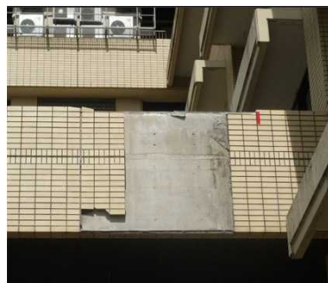
老朽化による不具合の例 (外壁の劣化)
