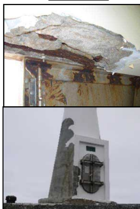
顕著な劣化を認めてから修繕
