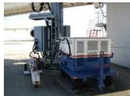
GPU(地上動力設備)4台配備
