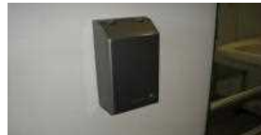
人感センサー式照明の設置
