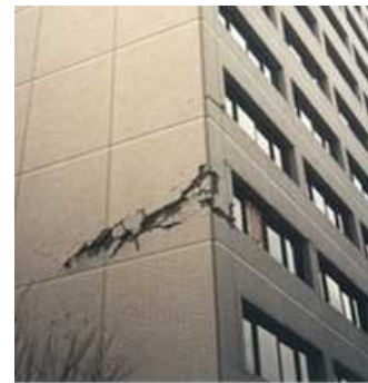
耐震性の不足等
