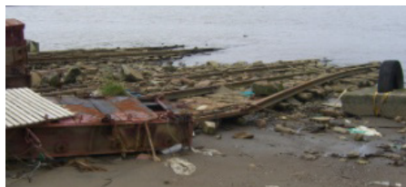
被災直後の鈴木造船所の船台 （船台のレールが湾曲し修復が困難な状態）
