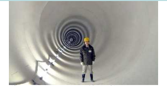
下水道による雨水貯留管の整備(名古屋市)
