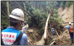
広島土砂災害における被災調査
