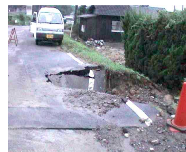
出水被害(道路陥没)
