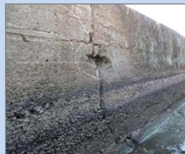
摩耗による骨材の露出
