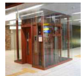
エレベーター (鉄軌道駅)
