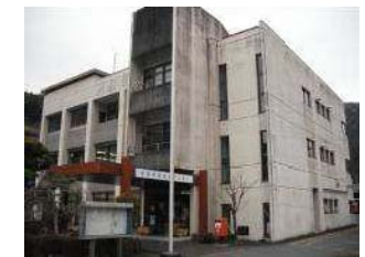
老朽化した公共施設
