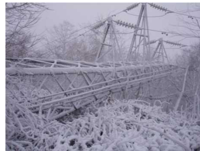
強風による鉄塔倒壊(登別市)
