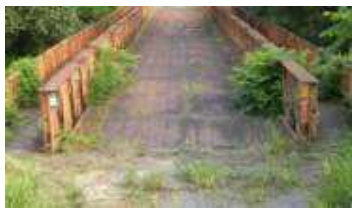
老朽化した橋
