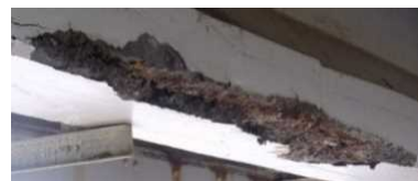
■ 凍害・塩害等による損傷・劣化
