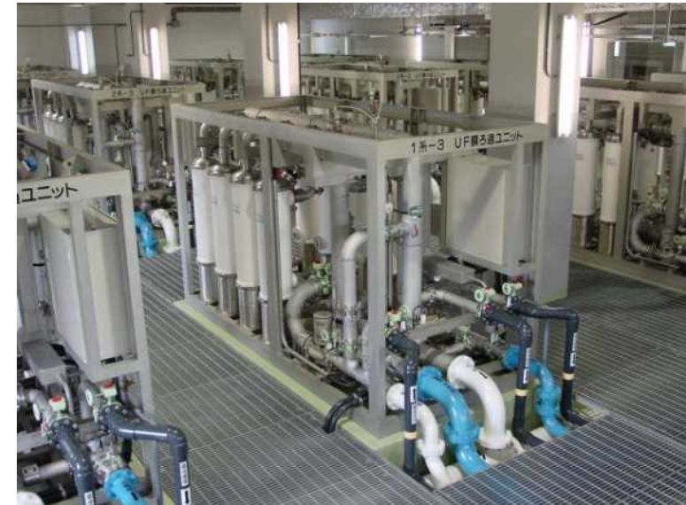
西空知広域水道企業団(膜ろ過施設)
