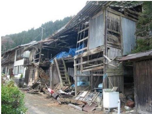
倒壊のおそれのある空き家
