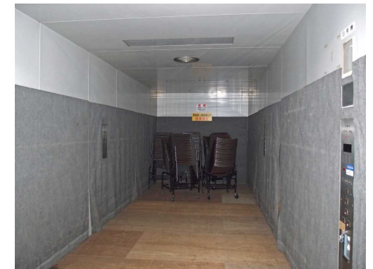
かご内の積載状況
