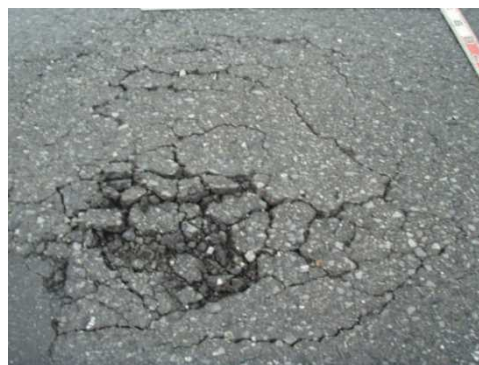
アスファルトと骨材の分離（粒状化）
