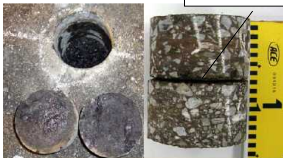
層間剥離（コアボーリング）
