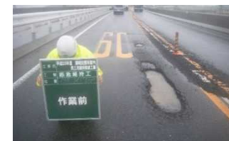
ポットホールの例 国道23号(愛知県西尾市)
