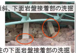
Co支柱の下面岩盤接着部の洗掘
