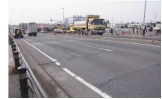
段差の例 国道4号(埼玉県春日部市)
