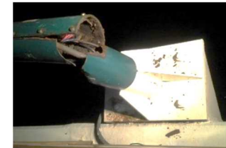
照明柱が根元から転倒 国道9号江川橋側道橋 (島根県江津市(H26.12.22))
