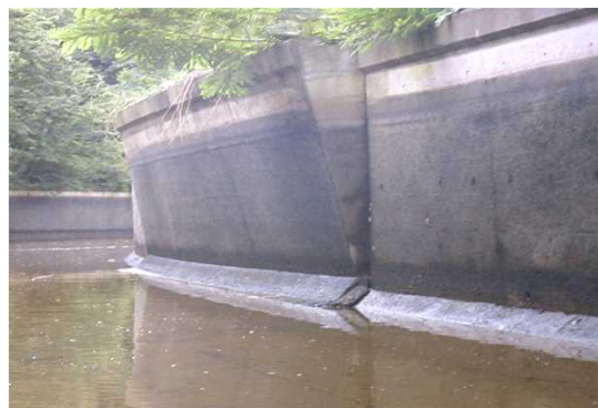
幹線用水路の側壁の倒壊
