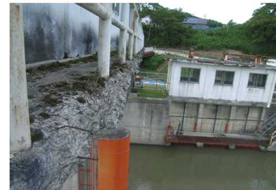
頭首工のコンクリートの劣化
