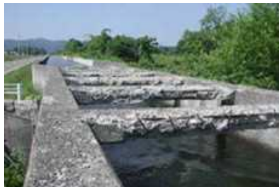
幹線用水路のコンクリートの劣化
