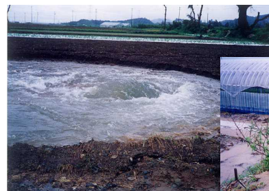
伊良湖サイホン漏水状況
