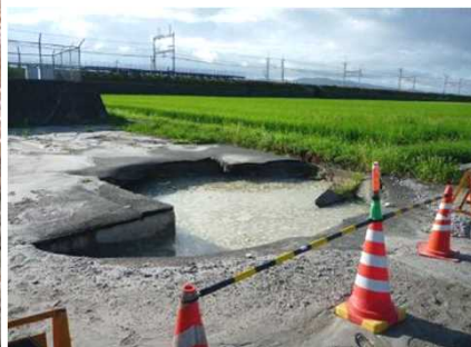
漏水による排泥工周辺陥没状況
