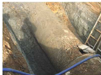
漏水箇所の状況
