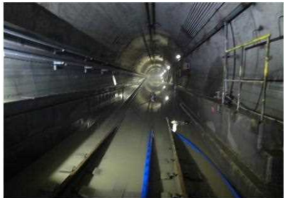
京都市営地下鉄東西線の浸水状況 （京都市交通局提供）
