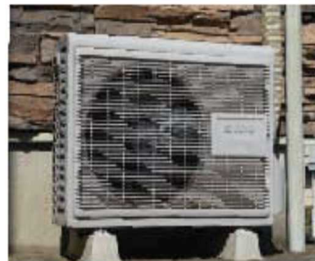
空気熱源ヒートポンプ
