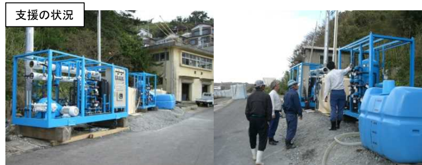
海水淡水化装置設置状況
