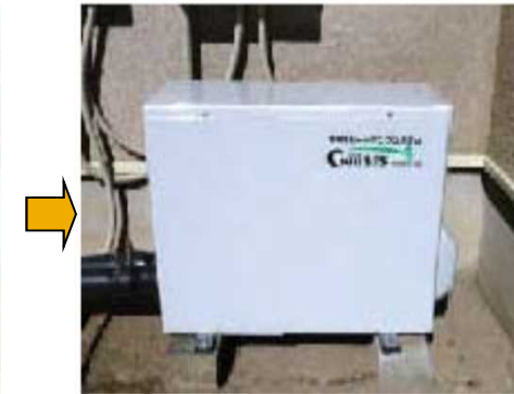
地下水熱ヒートポンプ
