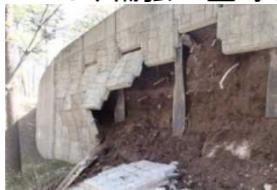
補強土壁の損傷
