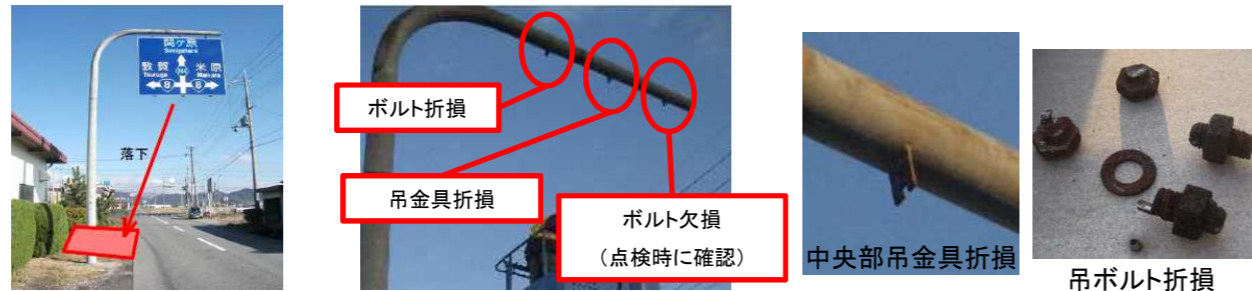
吊り下げ式標識の吊金具折損により標示板が落下した事例
