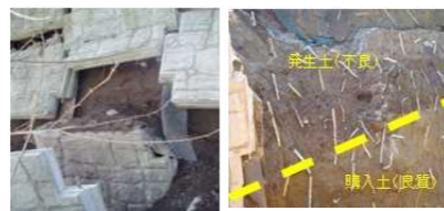
良質土を使用すべき箇所への誤適用(補強土壁)
