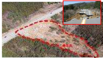
排水不良に起因する法面崩落
