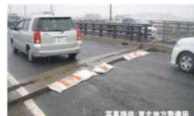
地震時の段差
