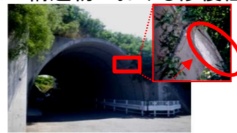
アーチカルバートの損傷
