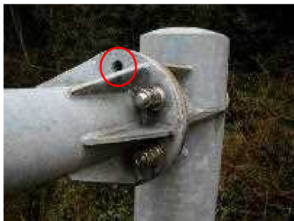
ボルトの脱落事例 ＜国土技術政策総合研究所資料より転載＞
