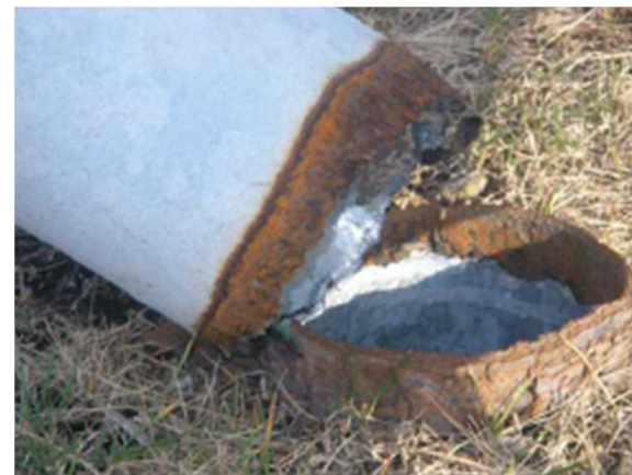
腐食による損傷事例 ＜国土技術政策総合研究所資料より転載＞
