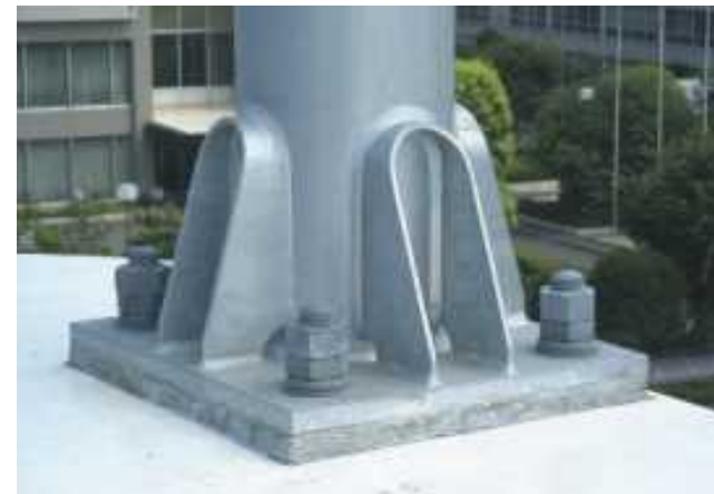
耐久性を考慮し、リブ形状を改善した事例 〈首都高速道路での対策事例〉
