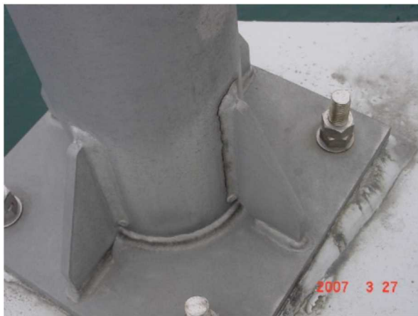
支柱基部のリブ取付溶接部に発生した損傷事例 〈門型標識等定期点検要領より転載〉
