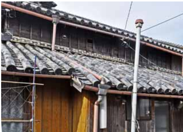
【写真 57 : 東側下屋 軒瓦の垂下】
