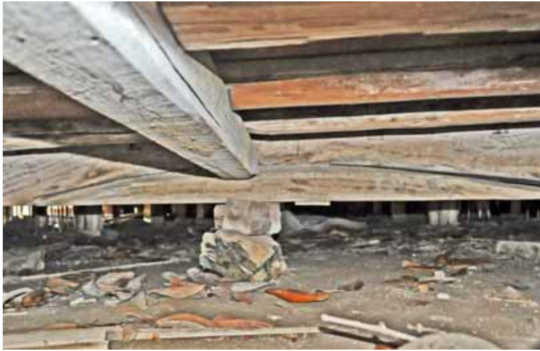
【写真 55 : 床組 大引の折損】
