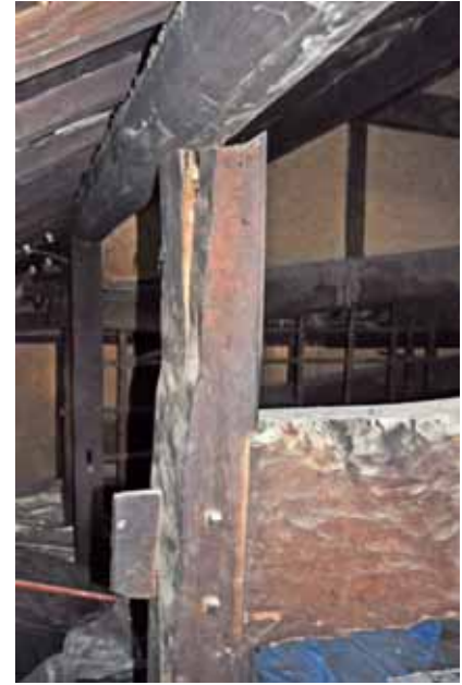
【写真 56 : 小屋組 柱上部の割れ】
