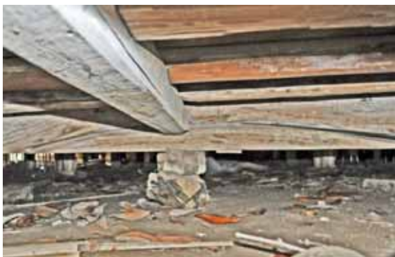
【写真 45：床組 大引の折損】
