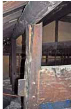
【写真 46：小屋組 柱上部の割れ】
