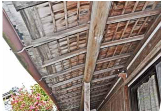
【写真 58 : 西側広縁 化粧垂木の曲りと折損】
