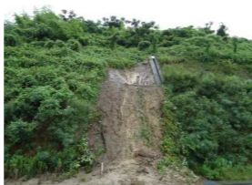
写真1 法面崩壊状況
