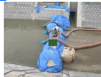
ポンプ運転状況
