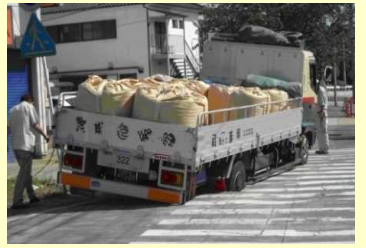
下水管きよに起因した道路陥没
