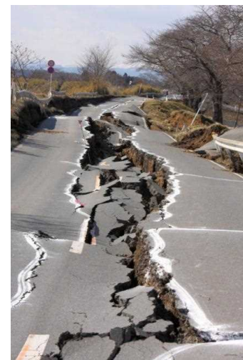
▲ 破壊された道路
