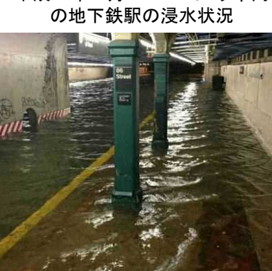
平成24年10月 ニューヨーク市内の地下鉄駅の浸水状況
