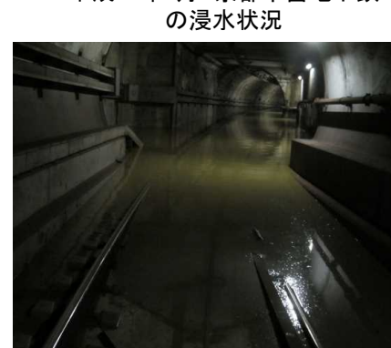
平成25年9月 京都市営地下鉄の浸水状況
