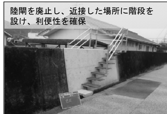
【陸閘の統廃合:高知港海岸】
