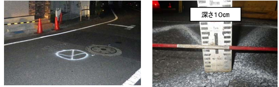
東京都北区での陥没事例(平成25年8月)
