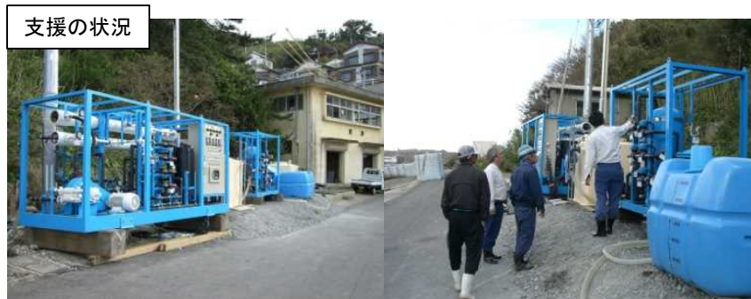
海水淡水化装置設置状況
