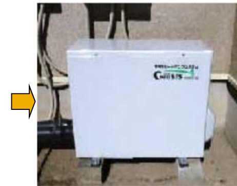
地下水熱ヒートポンプ
