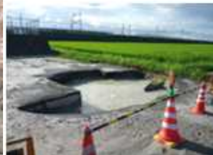
漏水による排泥工周辺陥没状況
