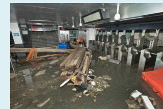
地下鉄駅の浸水状況 ©MTA
