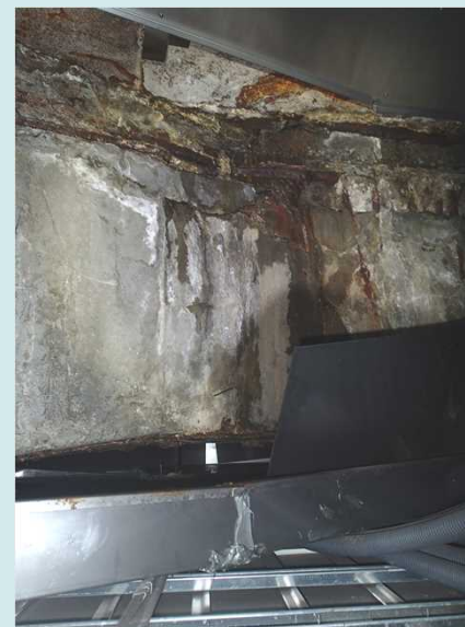
老朽化した地下街の問題箇所
