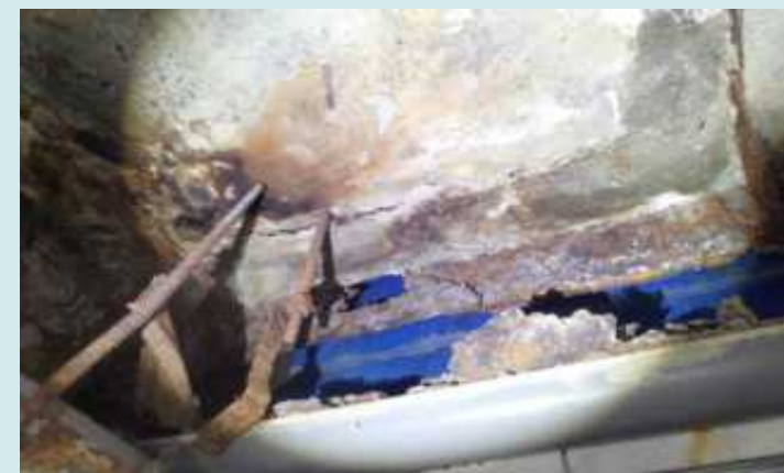
漏水により発錆した地下街の天井裏
