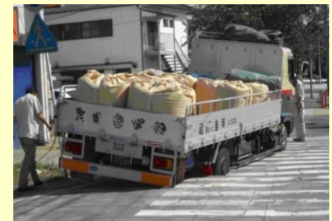
下水管きょに起因した道路陥没
