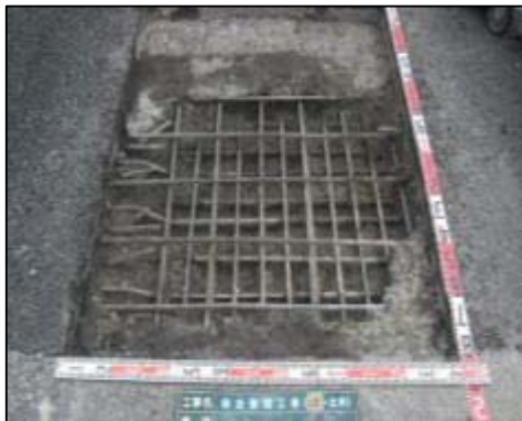
床版コンクリートの陥没
