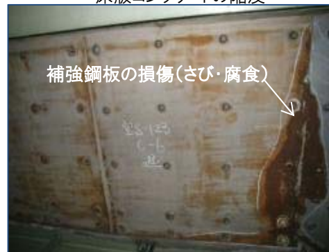
補強鋼板(鉄筋コンクリート床版下面)の損傷
