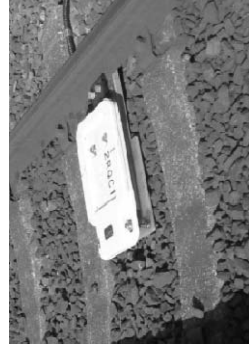
信号保安設備 (自動列車停止装置(ATS))
