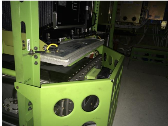
バッテリー覆い箱周辺の状況
