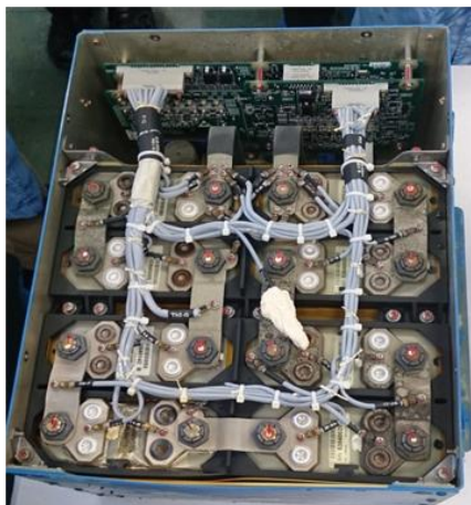
バッテリー内部の状況
